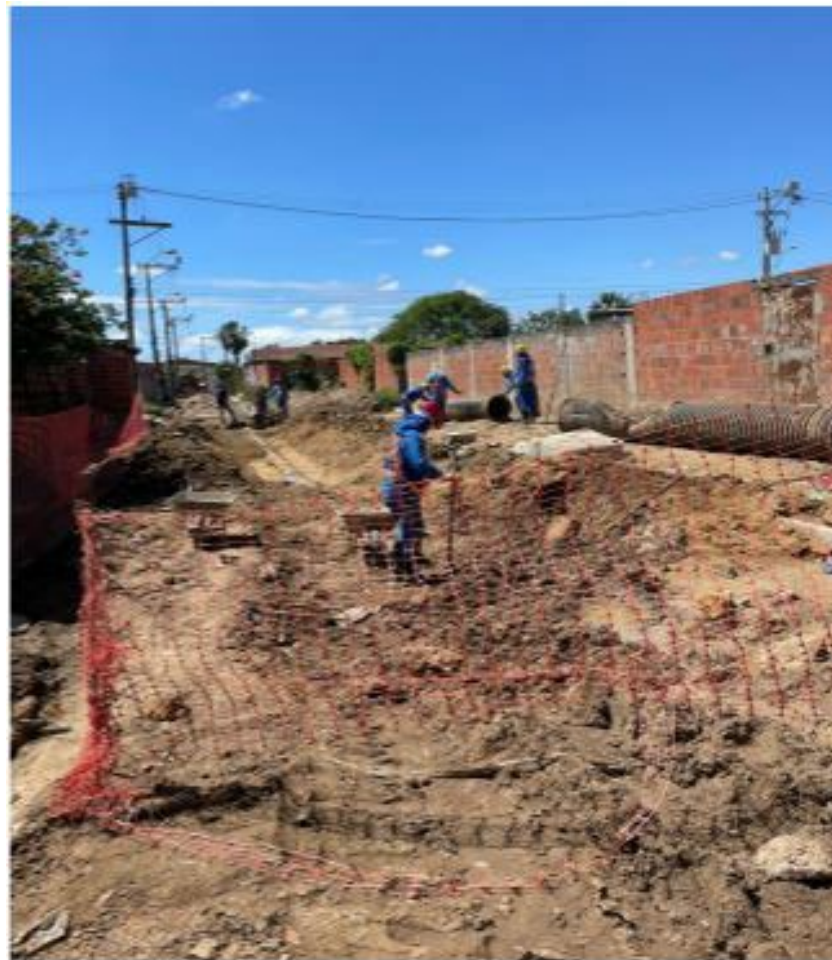
Trabalhadores na obra em andamento Fonte: Centro de Defesa da Vida Herbert de Souza
