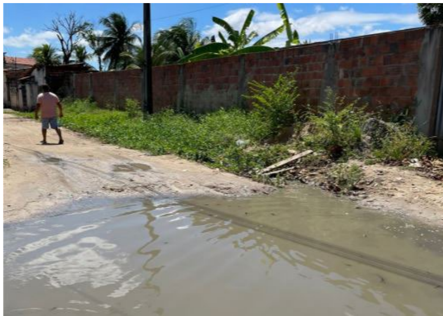
Ponto de alagamento na comunidade Fonte: Centro de Defesa da Vida Herbert de Souza
